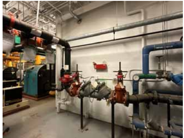
28 - FIRE SPRINKLER RISERS
